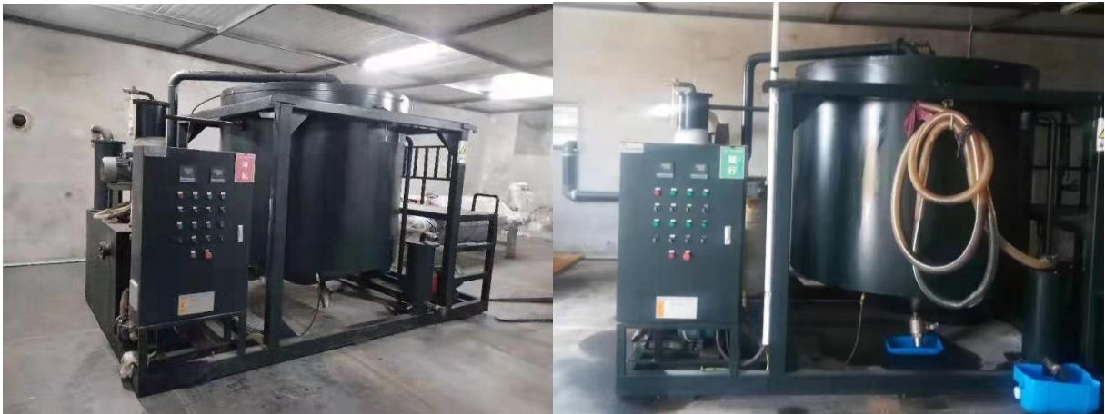
图3-4 真空泵废油回收设施照片
